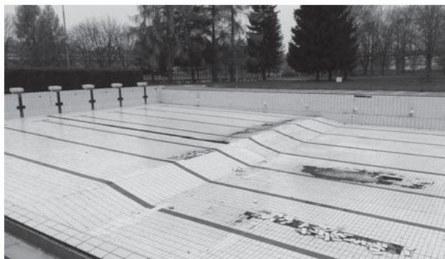
Odskakující dlaždičky jsou viditelným, nicméně nejméně závažným problémem bazénu. Po pětatřiceti letech se začínají jeho konstrukce zcela rozpadat.
